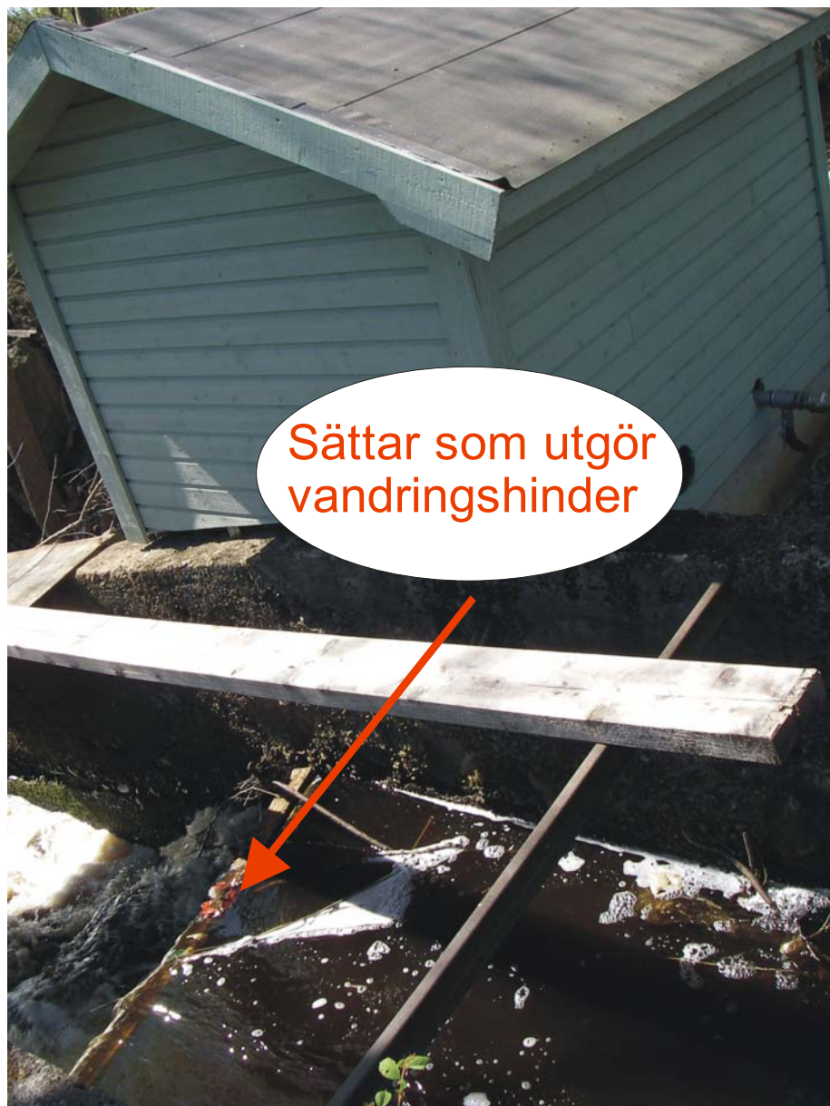
Figur 8 visar den del av betongrännan där sättar sitter i och utgör vandringshinder för öring under alla flöden.
